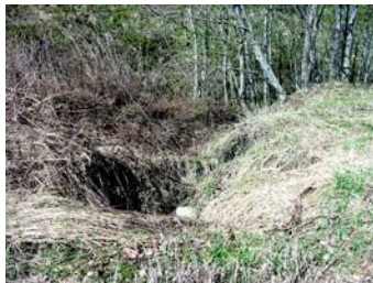
Ras ved rørutløp, utbedring er nødvendig
